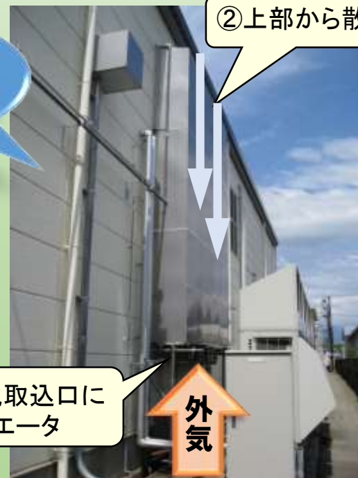
改善後の給気ダクト
